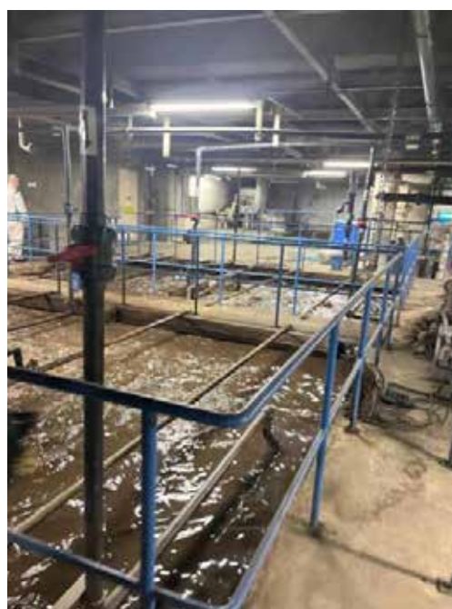
排水浄化施設
